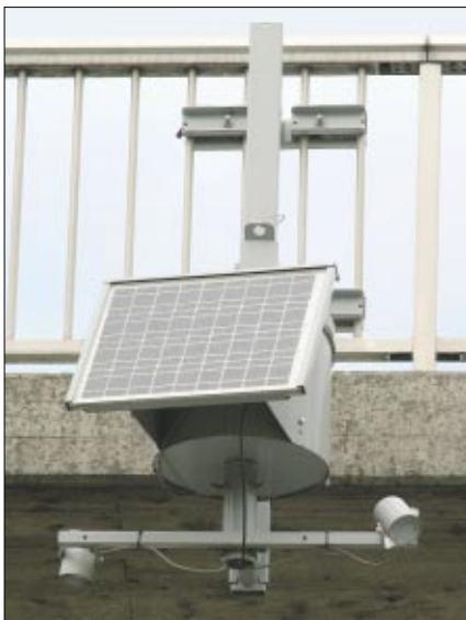
Diese Verkehrssensoren gehören der T-Systems, sie überwachen nur die jeweils ganz linken Spuren. Sie verfeinern das Netz der Induktionsschleifensensoren nur etwas.
