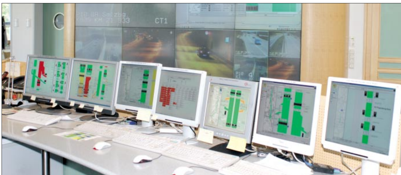
Hier in der Verkehrsleitzentrale der Autobahndirektion Südbayern laufen die Infos der Fahrspuren zusammen. Auf dem linken Monitor sehen Sie rot eine Störung, die Sie im ersten Foto dieses Artikels wiederfinden.
